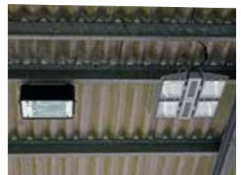
Alte und neue LED Beleuchtung im Wellenkanal.
