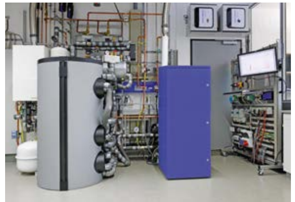
Für die effiziente Versorgung moderner Siedlungen mit Strom und Wärme bietet sich die Kraft-Wärme-Kopplung an. NEXT ENERGY verfügt über institutseigene Teststände zur Erforschung und Evaluierung dieser Anlagen.
