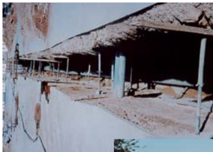
Abbildung 5 Bau von Dränleitungen unter der Straße einer Stadt, um hohe Grundwasserstände abzusenken.
