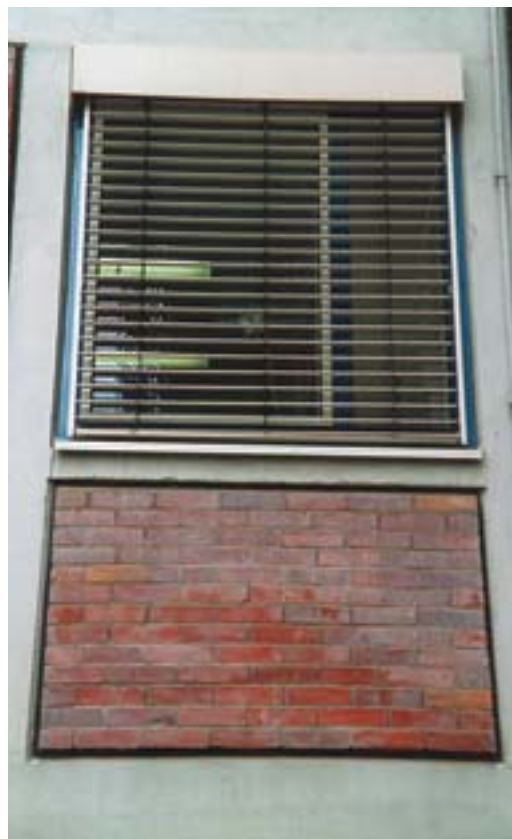
Bild 4 Diese Ziegelfläche wurde hydrophobiert, als die Poren mit Wasser gefüllt waren. Das Resultat ist ein auf der Oberfläche liegender, sich weiß absetzender Wirkstoff.
