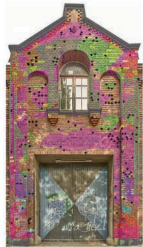
Basis für die Fassadenanierung ist der fotogrammetrische Bildplan – er kartiert die Salz- und Fugenschäden sowie Graffiti an der Fassade.
